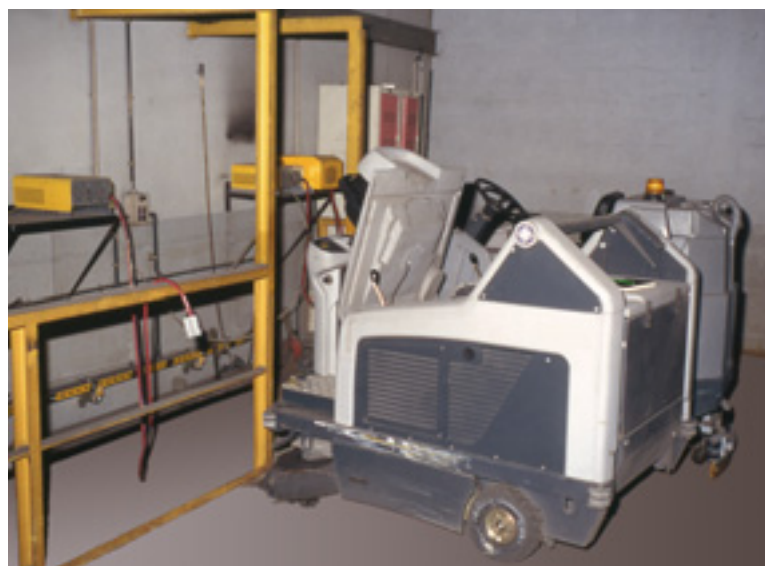
43. Local de recharge des batteries
